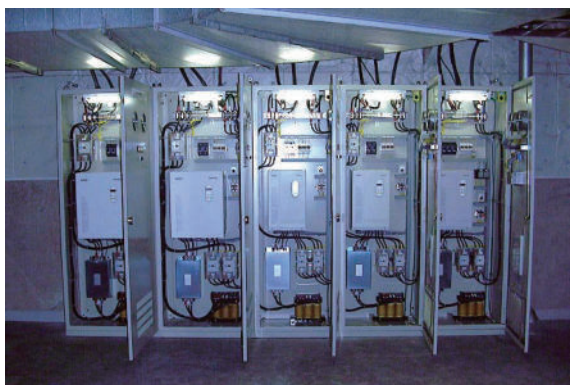
省電力制御盤設置例
